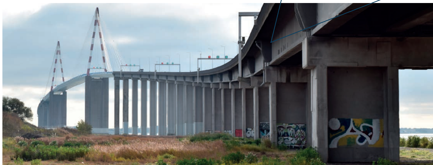
Most Saint-Nazaire byl postaven v 70. letech 20. století a stále je nejdelším mostem ve Francii. Většina jeho betonové výztuže nebyla chráněna proti korozi, což vedlo k rozsáhlému programu údržby a oprav. Na velmi specifických místech – přírubách konců T-nosníků a spojovacích deskách odlitých na místě ve výšce přírub (na obrázku výše) – bylo použito přibližně 63 tun žárově zinkované ocelové výztuže. Na konkrétních místech, kde byla použita žárově zinkovaná výztuž, nebyly nutné žádné opravy.
