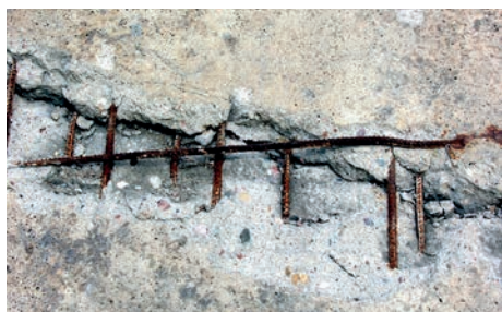
Praskání a odlupování betonu v důsledku koroze výztuže
