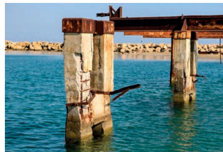
Výztuž a degradace betonu v (přímořském) prostředí s vysokým obsahem chloridů
