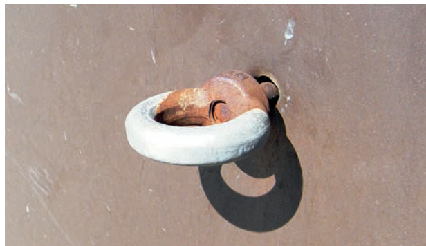
Obr. 10-14 – Původně pozinkované kotvící oko na měděné střeše.
