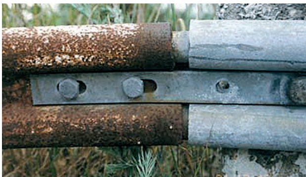
Obr. 1-1 – Nalevo je korodující svodidlo opatřené nátěrem. Pro porovnání je vpravo svodidlo žárově zinkované.
