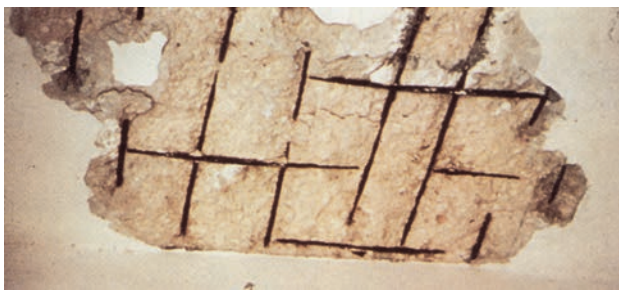
Obr. 10-15 – Odlupování krycí vrstvy betonu nad armaturou v důsledku koroze.
