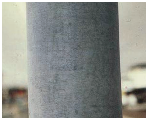
Obr. 10-1 – Exponovaný povrch zinkového povlaku. Lesklý povrch mizí a je nahrazen šedými korozními produkty, často nazývanými zinková patina.
