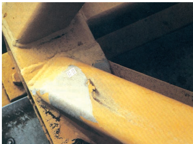
Obr. 11-3 – Odlupování vrstvy nátěru dané špatnou předúpravou před provedením nátěru (22).
